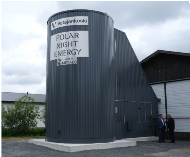
Kuva 17 Kankaanpäähän Vatajankosken voimalaitosalueelle rakennettu ensimmäinen kaupallinen Polar Night Energyn hiekka-akku. (Polar Night Energy Oy, 2022)
