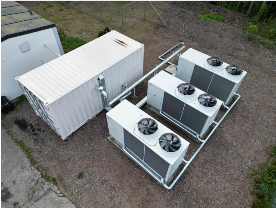
Kuva 6 Kolme 100 kW:n CO 2 -ilmavesilämpöpumpua Riihimäellä. (Finess Energy Oy, 2024)
