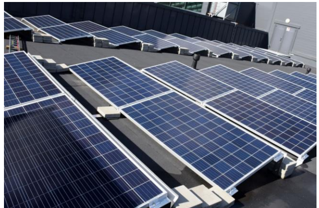
Aurinkopaneelit kauppakeskuksen katolla (Kuva: Yle)
