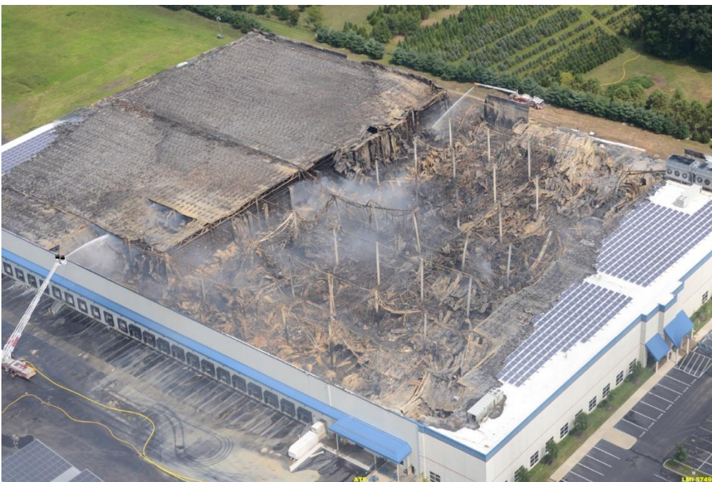
Aurinkosähköjärjestelmän tulipalo vuonna 2013 New Jerseyssä varastorakennuksessa, jonka katolla oli yli 8 000 aurinkopaneelia (Milke et al. 2014, 4-5). (Kuva: Reax Engineering)
