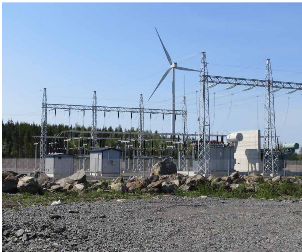
Kuva 2. Sähköasema Porin Peittoossa (Mariikka Manninen).
