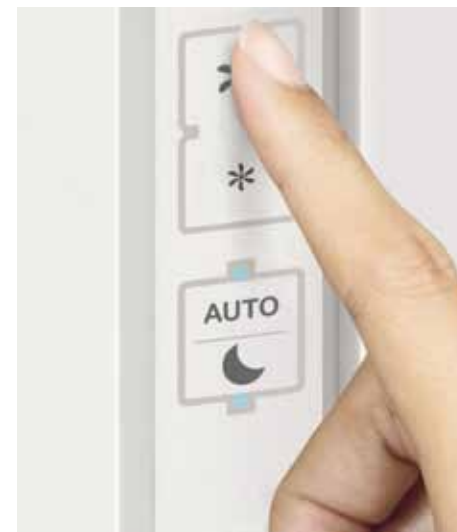
Kuva 65 (yllä). Ilmanvaihtolaite toimii automaattisesti, mutta halutessaan asukas voi säätää ilmanvaihtotehoa myös itse (kuva Skaala Oy).
